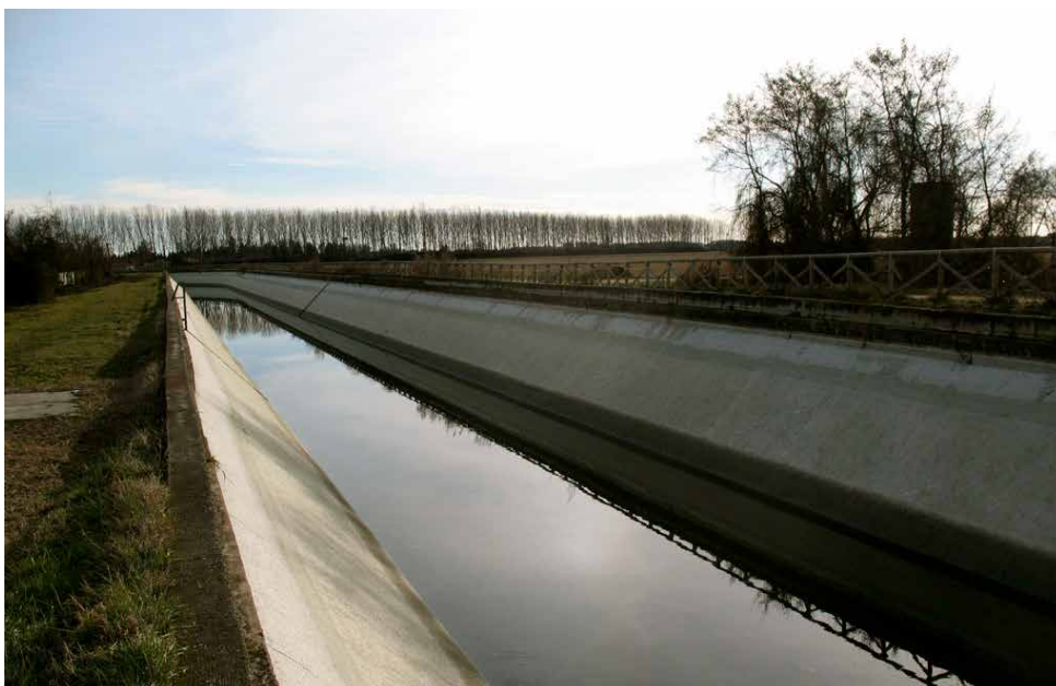
Canale rettilineo con argini cementati, dove la velocità dell'acqua è portata all'estremo dalla mancanza di anse, di vegetazione, di aree di infiltrazione sul fondo del canale ©euland.biz
