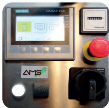
Quadro di controllo SIEMENS con sistema PROFINET
